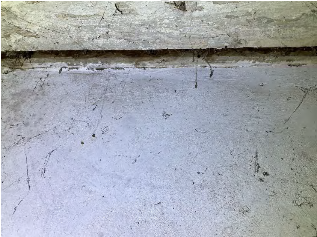
Abbildung 11.4-13. Spaltenraum über einem zugemauerten Fenster im Erdgeschoss des westlichen Teils der alten Tabakscheune, darin sind dichte, alte Spinnweben zu erkennen.
