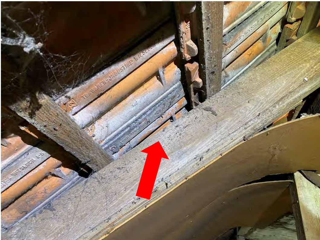
Abbildung 11.4-16. Spaltenraum zwischen Dachziegel und Verschalung im dritten Obergeschoss des westlichen Teils der alten Tabakscheune.
