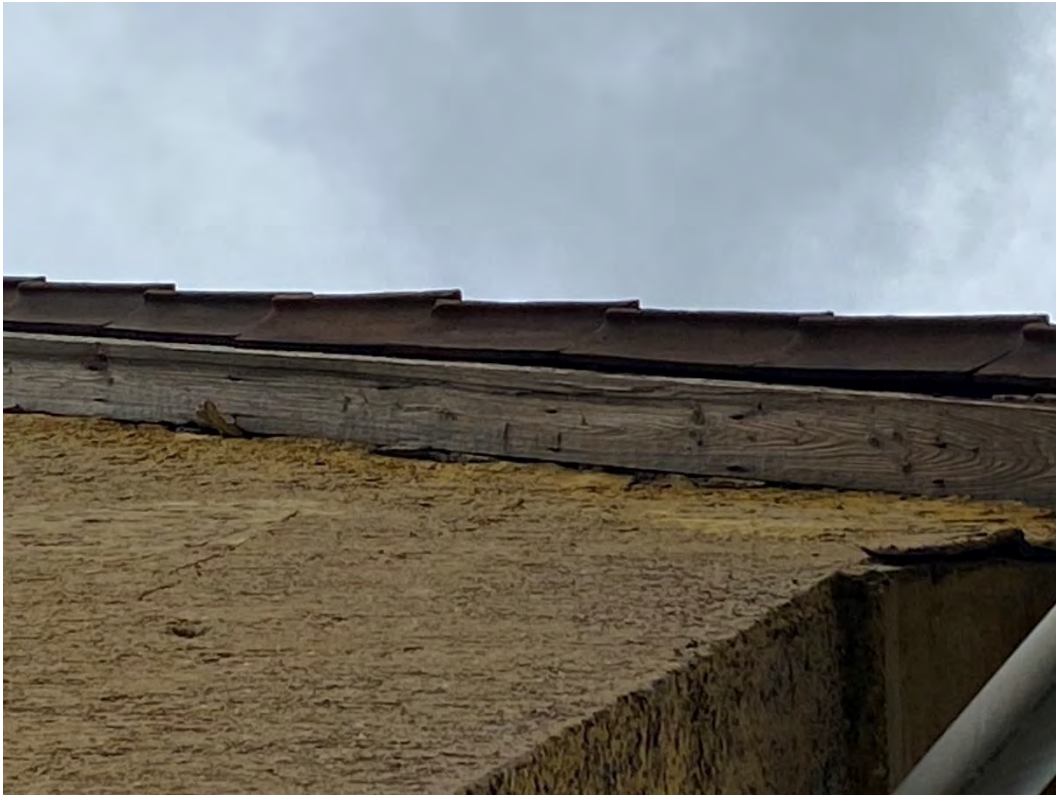
Abbildung 11.4-22. Spalte zwischen Mauerwerk und Holzverschalung unter dem Dachvorsprung an der Ostseite der alten Tabakscheune.
