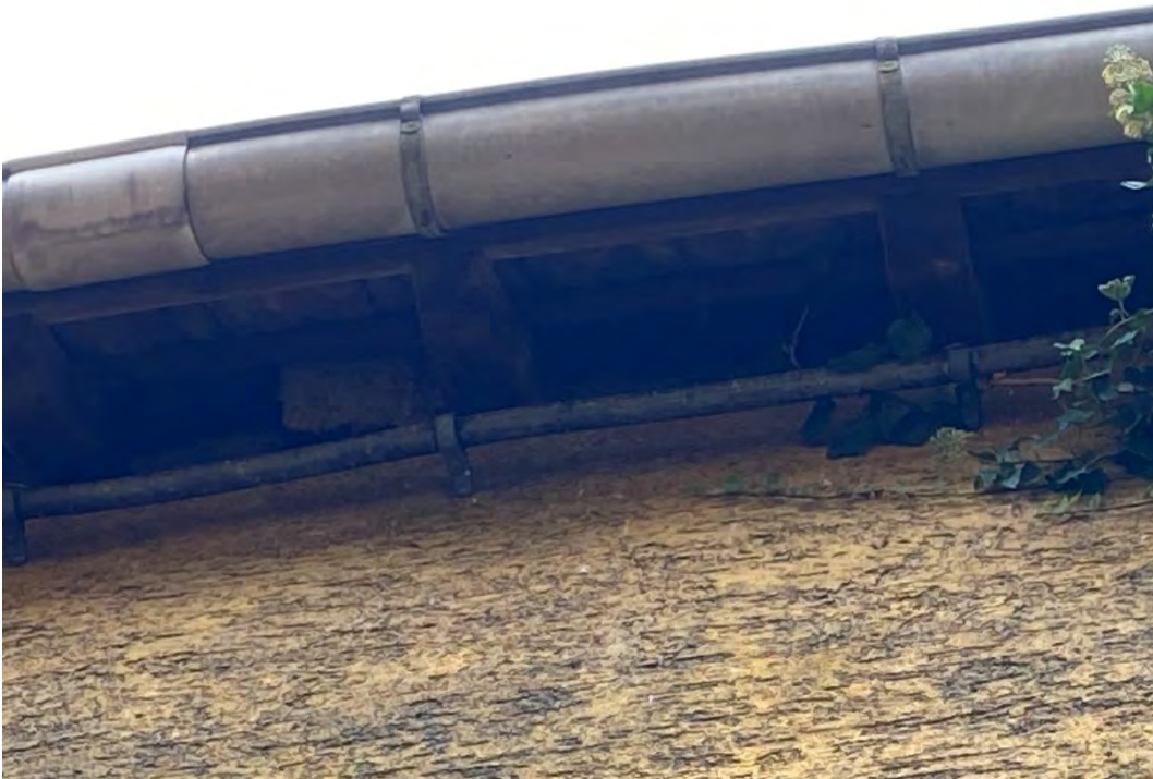
Abbildung 11.4-21. Spaltenraum zwischen Holzverschalung und Regenrinne im Süden der alten Tabakscheune.
