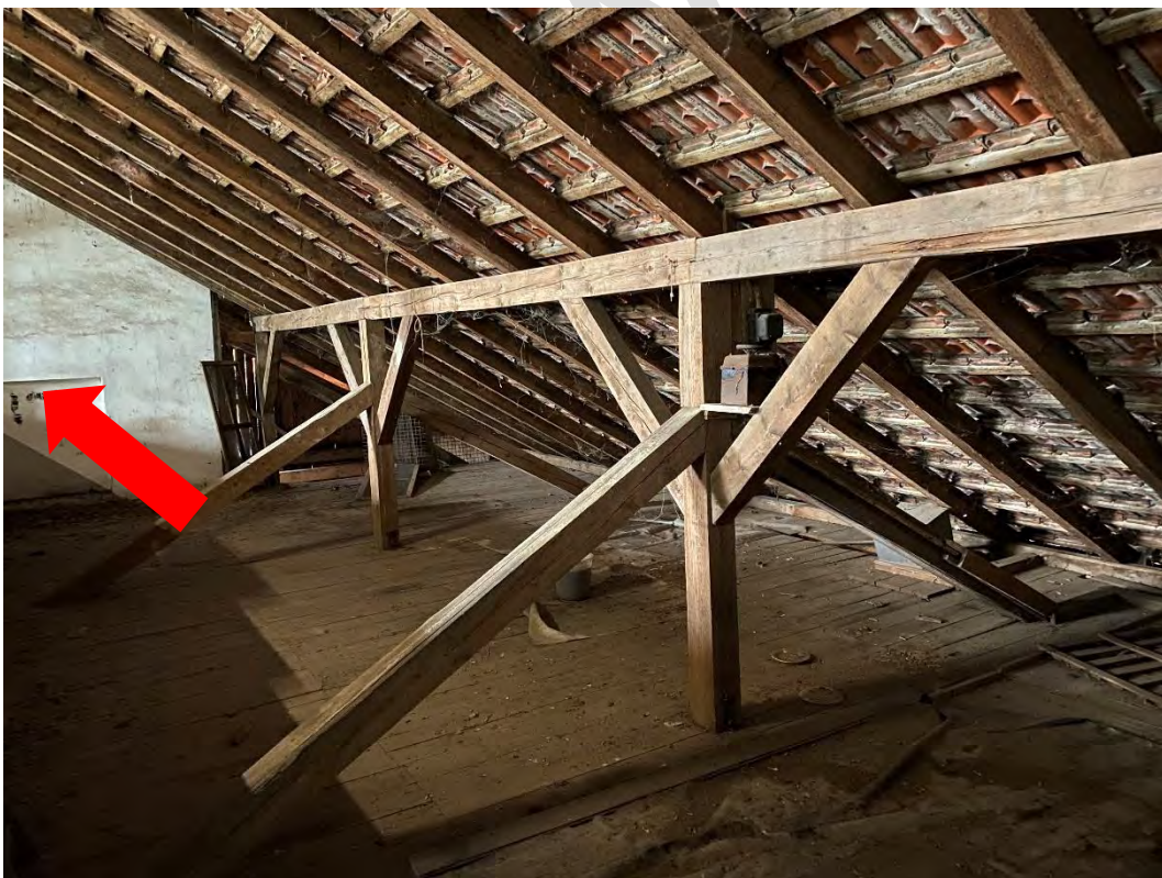
Abbildung 11.4-19. Spalten zwischen Dachziegeln und Gebälk und über einem zugemauerten Fenster im nordwestlichen Raum der alten Tabakscheune (roter Pfeil).
