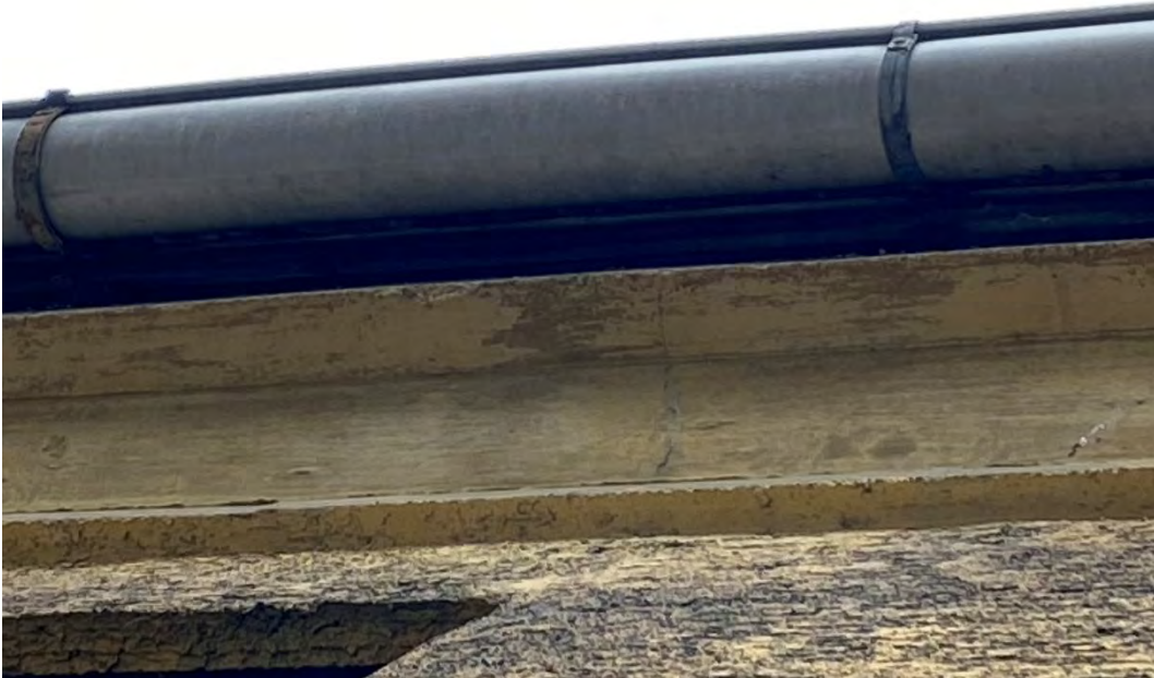
Abbildung 11.4-20. Spaltenraum zwischen Fassade und Regenrinne im Norden der alten Tabakscheune.
