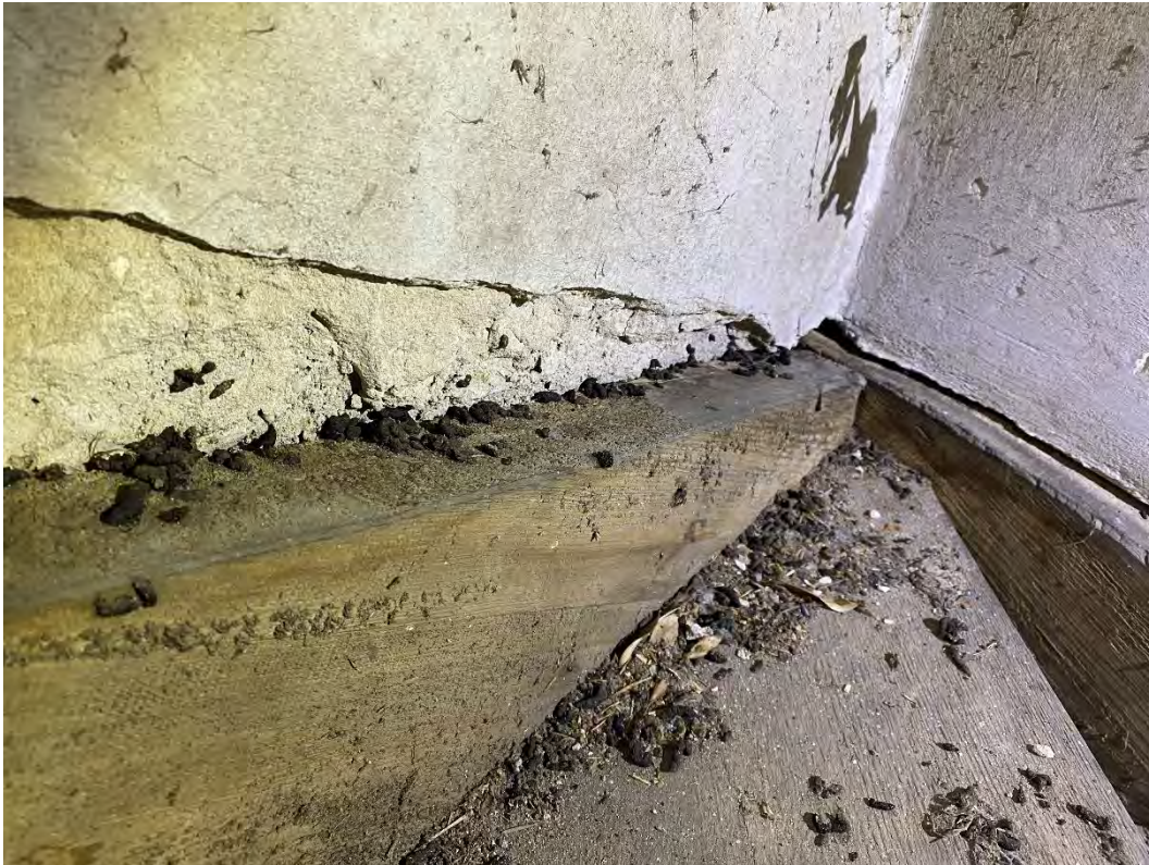
Abbildung 11.4-14. Nagetierkot auf der Treppe im Erdgeschoss des westlichen Teils der alten Tabakscheune.
