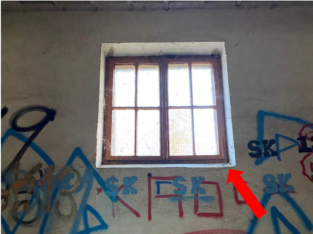
Abbildung 11.4-2 Fensterbank im westlichen Teil der alten Tabakscheune, auf der ein Pellet Fleudermauskot festgestellt wurde.
