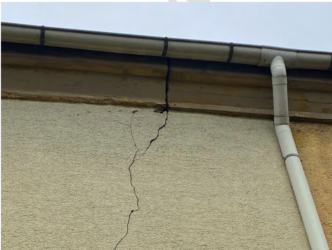
Abbildung 6.2.-26. Riss an der Südfassade der alten Tabakscheune.
