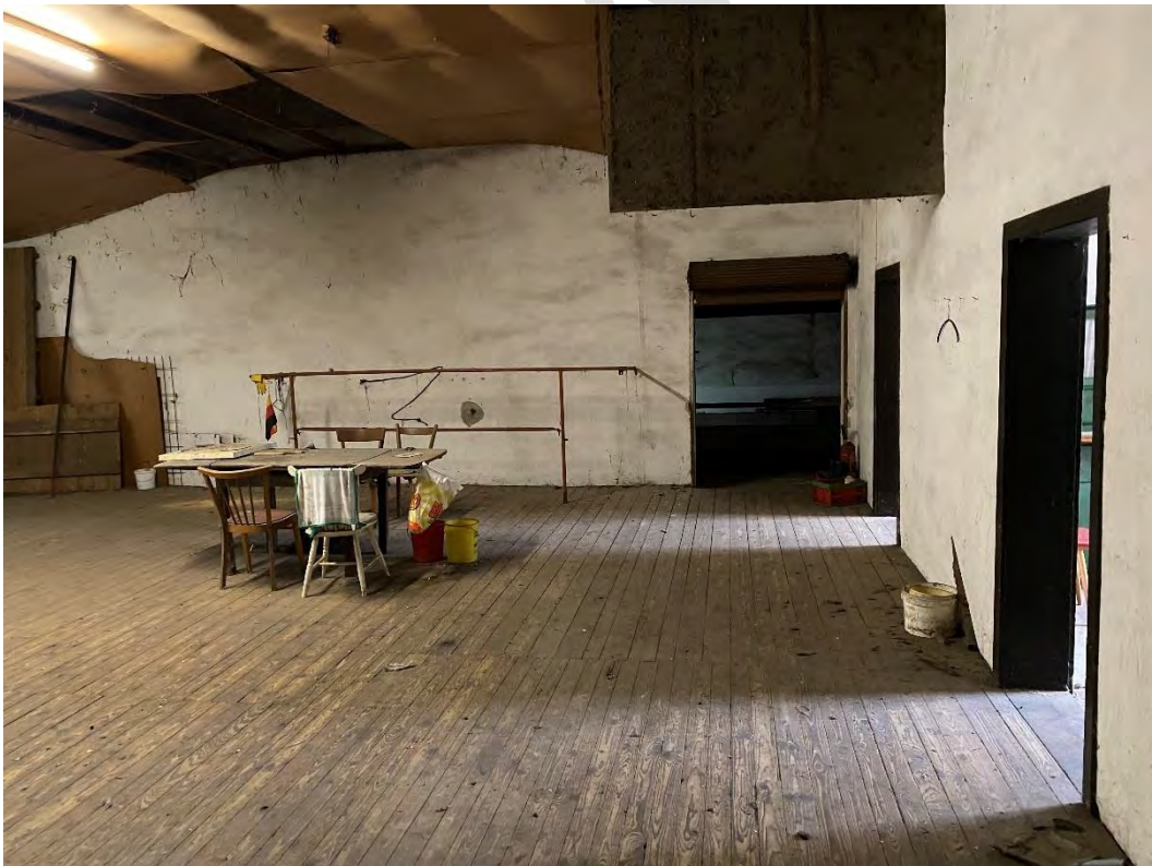
Abbildung 11.4-8. Obergeschoss des zentralen Teils der alten Tabakscheune mit teilweise beschädigter Decke.
